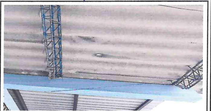
Foto 4: Techos con agujeros y en mal estado
