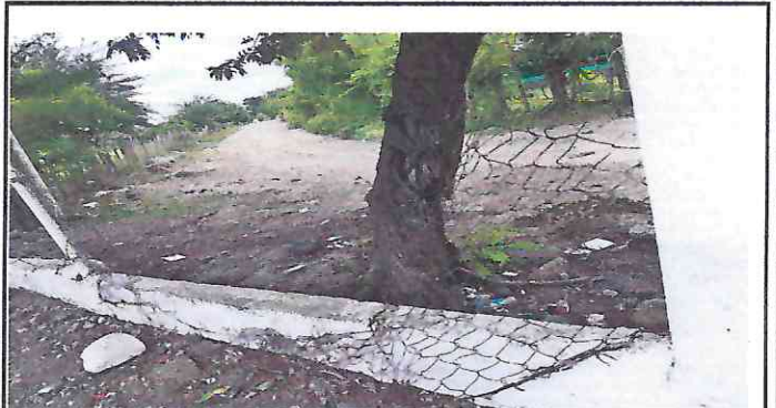
Foto 2: Malla del muro perimetral deteriorada
