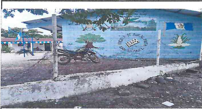
Foto 1: Muro perimetral en mal estado
